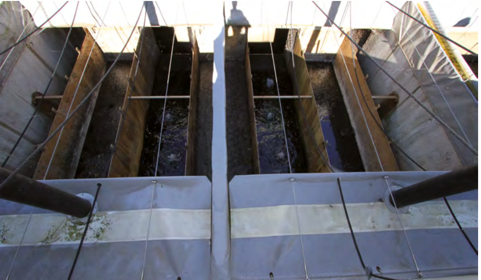
Décanteur lamellaire de la STEP de l'île Arrault
