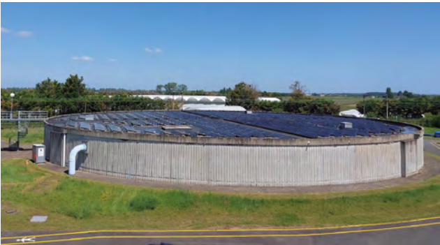
Solarisation de l'usine du Val
