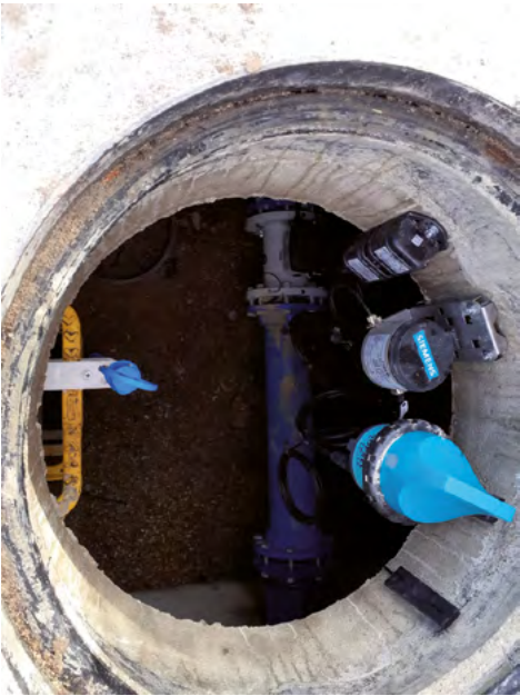
4-instrumentation du débitmètre pour télégestion des données vers Topkapi
