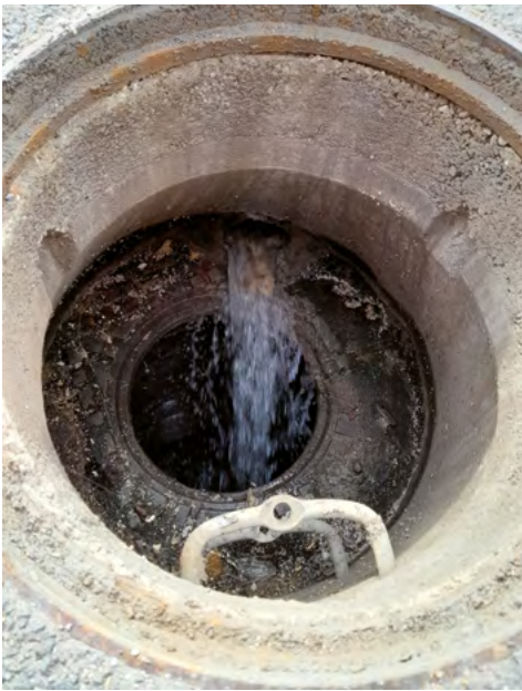
Fuite sur purge Saint Jean de la Ruelle
