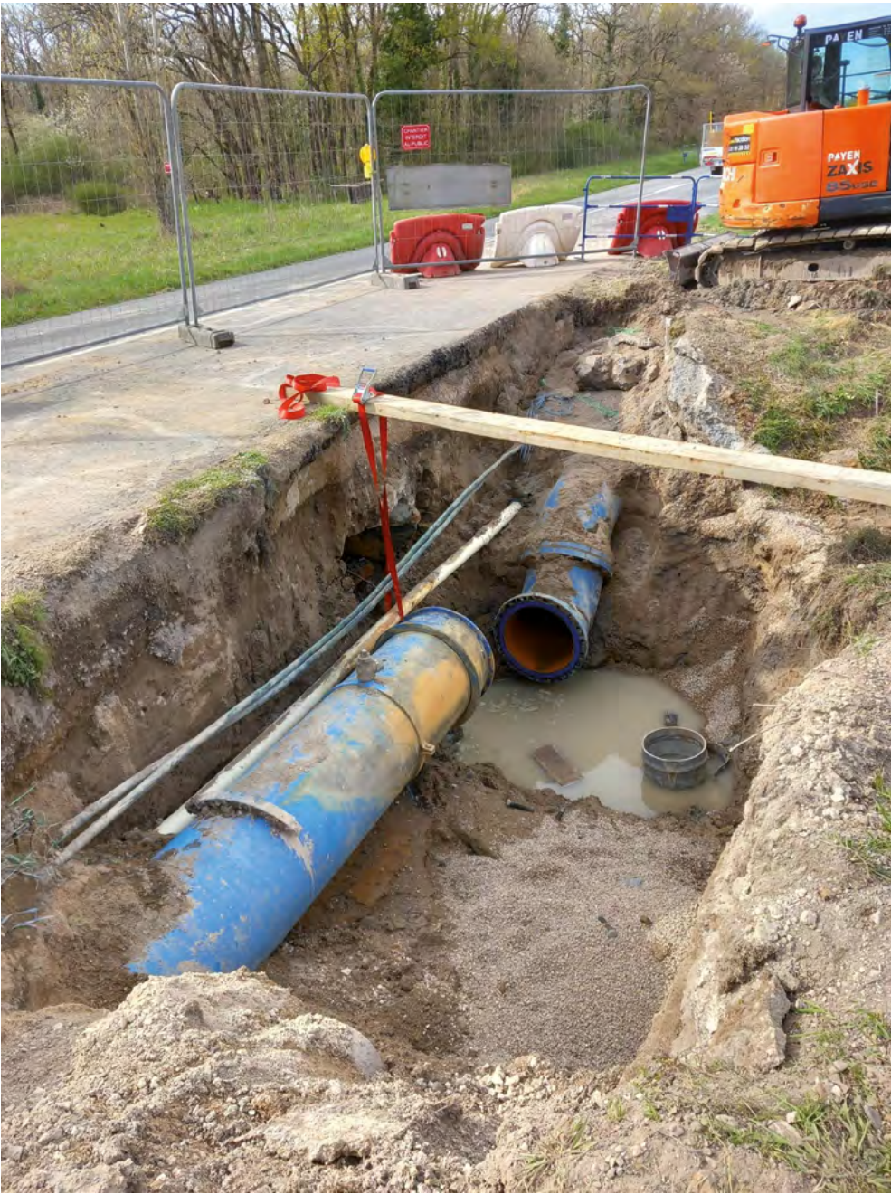
Casse de la conduite de refoulement au forage Oiselière
