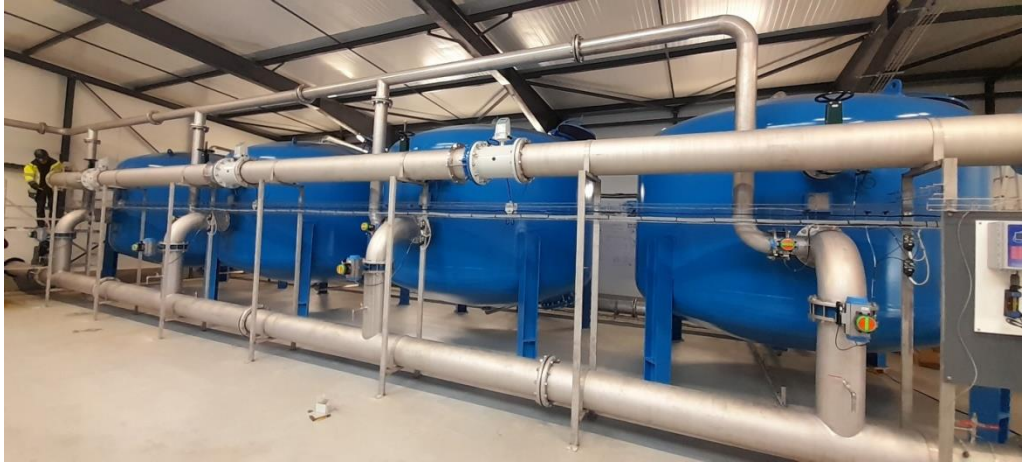
Usine de déferrisation démantanisation de La Source - 3 ème file de traitement
