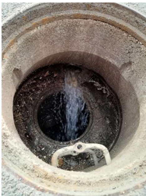
Fuite sur purge – Saint-Jean-de-La-Ruelle
