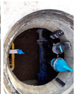
4. Instrumentation du débitmètre pour télégestion des données vers TOPKAPI
