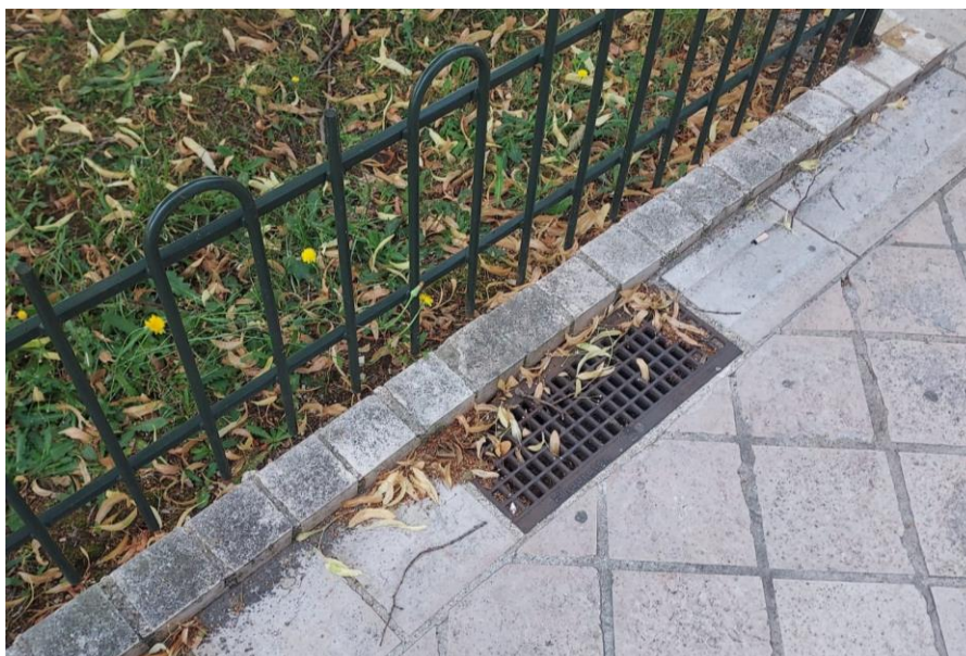
Exemple de grille redirigeant les eaux vers les espaces verts
